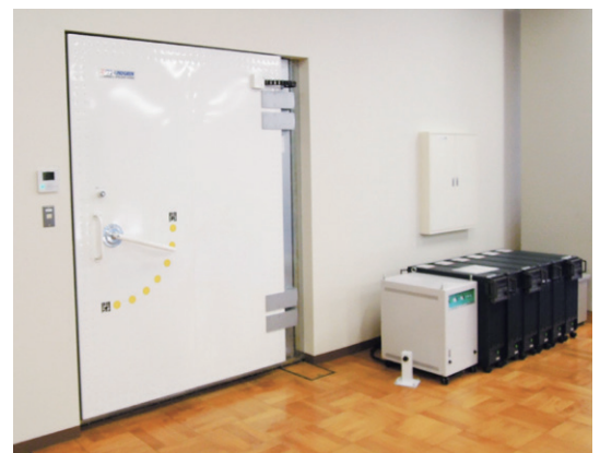
図2 増設した電磁波シールド室
